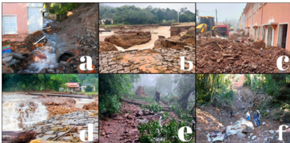
Figura 5 – Áreas de SJP danificadas pelo evento climático extremo de 2024.
