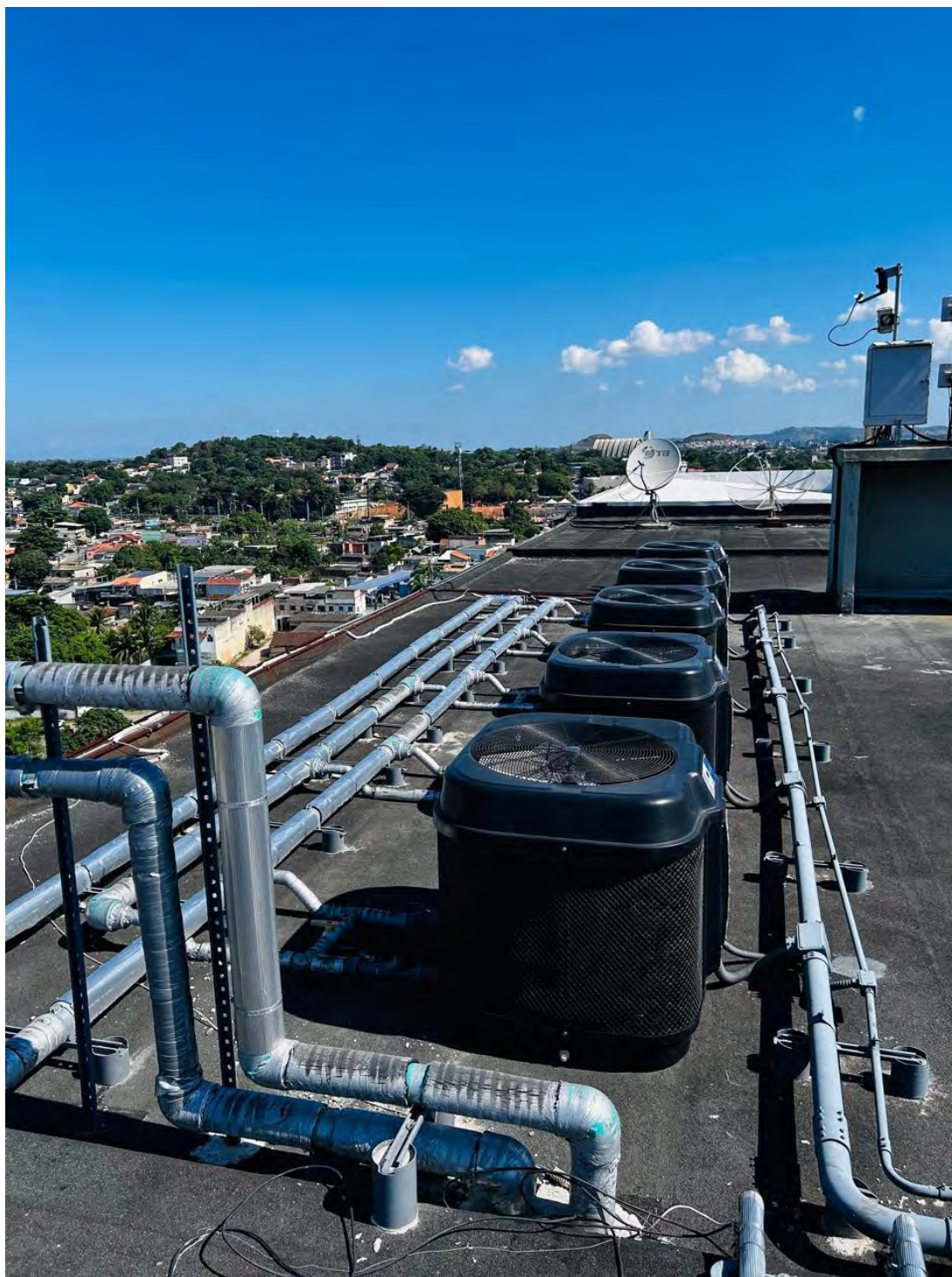
Figura 10 – Bombas de calor
