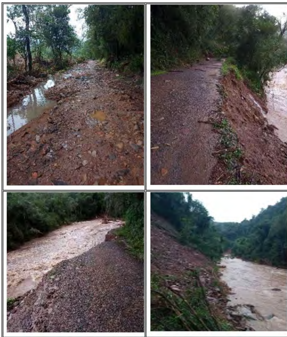
Figura 23. Danos em estradas e acessos.
