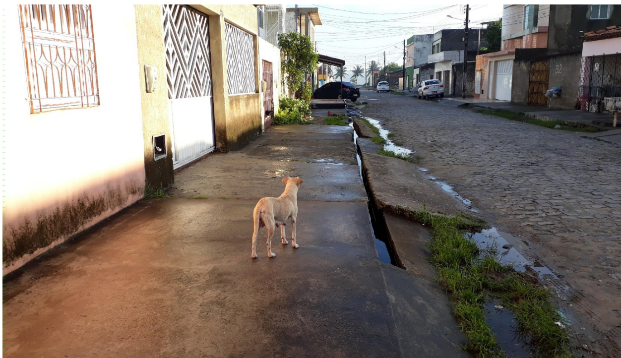
Figura 3 – logradouro sem infraestrutura de saneamento básico em São Cristóvão - SE.
